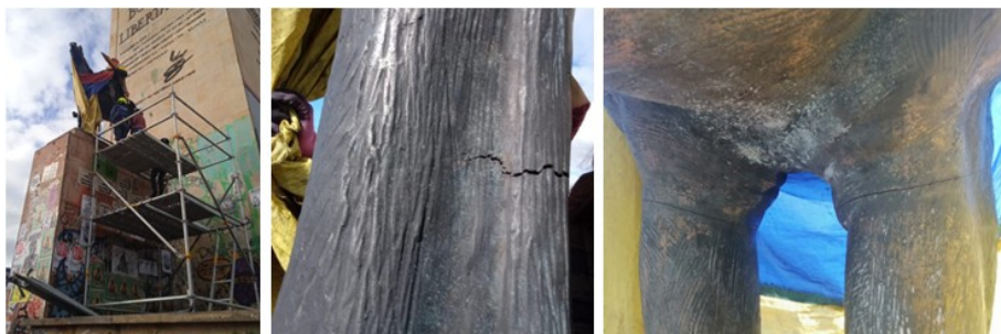
Imagen 1.- Registro fotográfico visita técnica adelantada donde se evidencian las afectaciones de la escultura. Fuente: IDPC-21-05-2021
